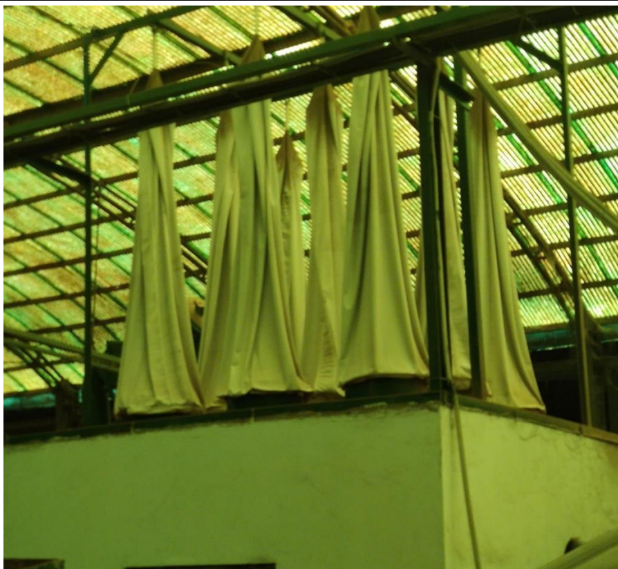
Hình 3.12 Hệ thống lọc bụi túi vải
