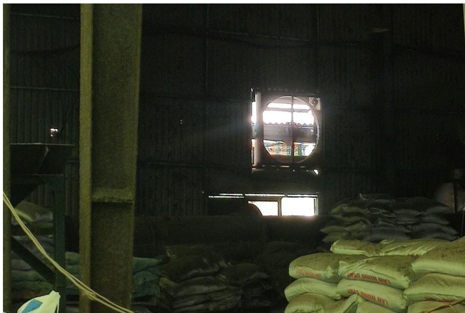
Hình 3.13 Quạt thông gió trong nhà xưởng
