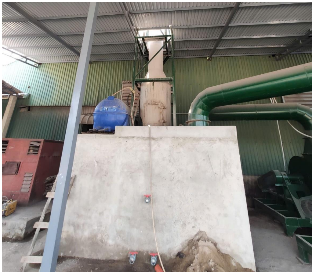
Hình 3.9 Hệ thống bể nước ống khói xử lý bụi, khí thải
