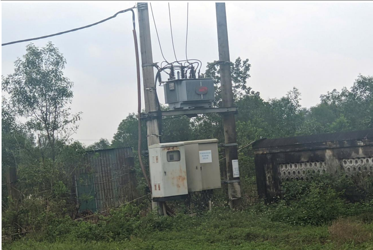
Hình 1.10 Trạm biến áp cơ sở
