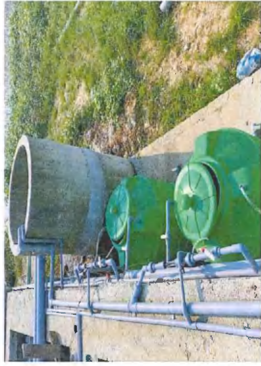
BỒN CHỨA HÓA CHẤT VÀ BỊ PHẢN ỨNG
