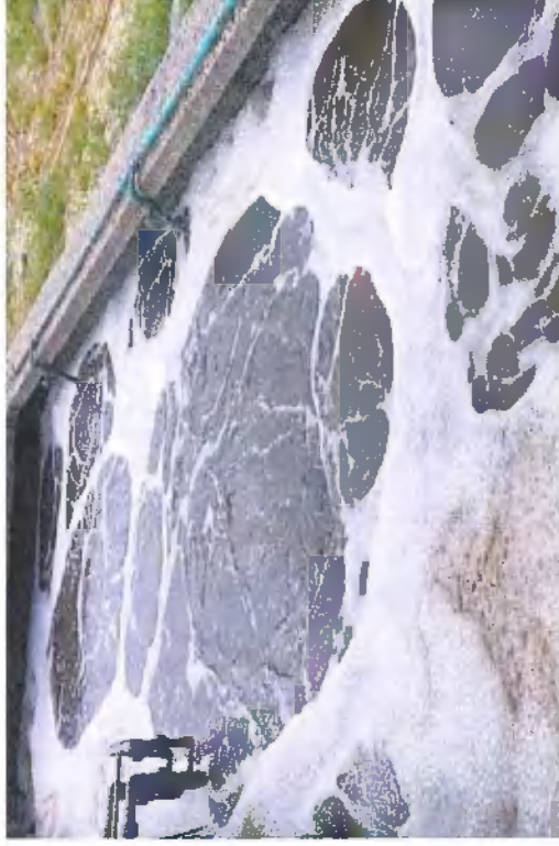
BỂ XỬ LÝ SBR
