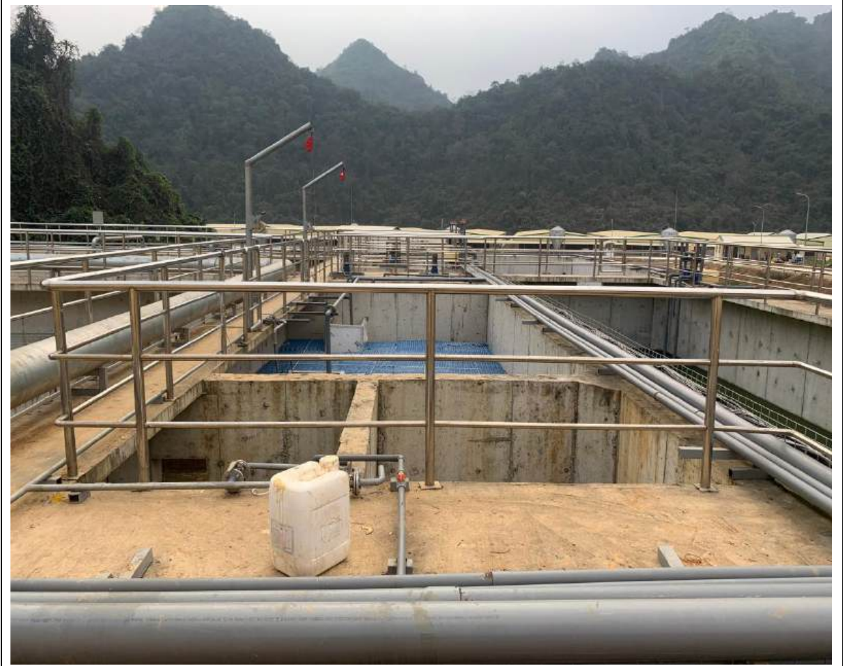
Hệ thống xử lý nước thải tương tự Chủ dự án đã áp dụng
